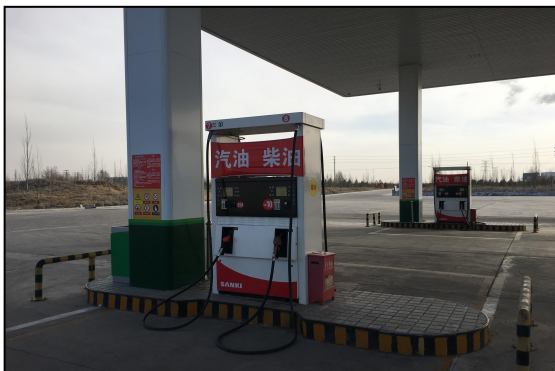
加油机上的油气回收装置
